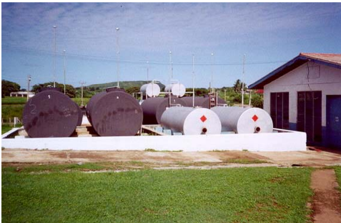
Figura 7.11. Tanques de combustível (óleo diesel) da Usina Termelétrica Tubarão.
