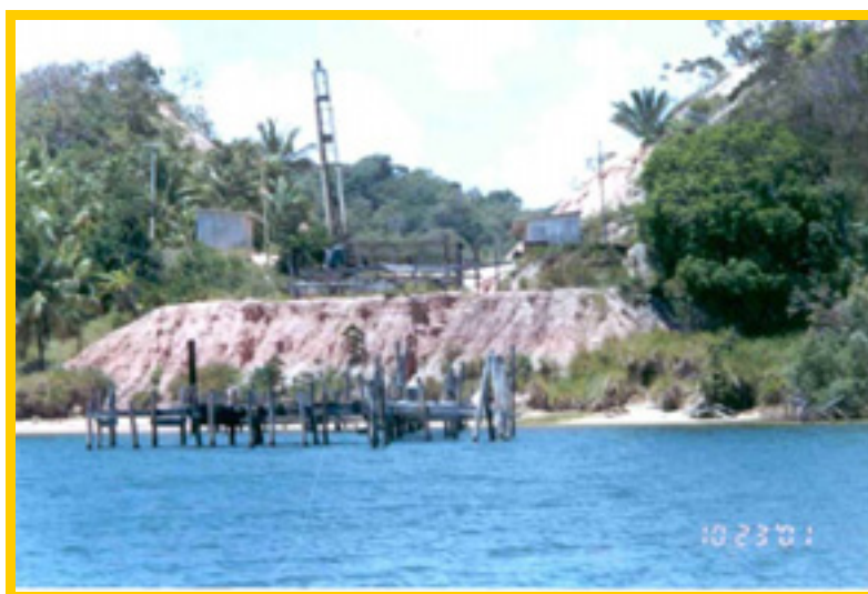
Fig. 39: Construção da ponte sobre o rio Ariquindá (obra embargada), Tamandaré (PE) Autora: Mércia Santos
