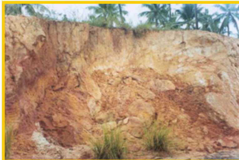
Figura 36: Instabilidade de encostas causada pela construção da Via Litorânea dos Carneiros (PE)
