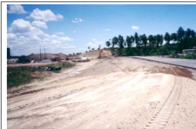
FIGURA 24 - Marcas da degradação do ambiente, em virtude da construção do Viaduto de Oitizeiro.
