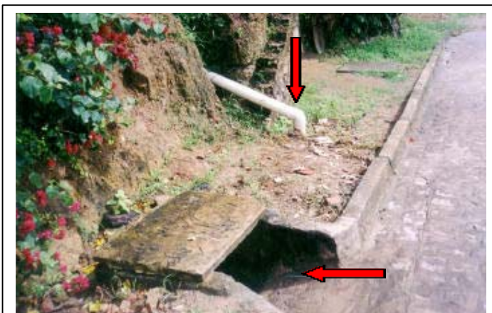
FIGURA 28 – Presença de ligação clandestina de rede de esgotos em galeria pluvial.
