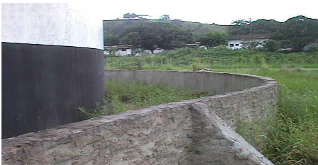
FIGURA 20 – Bacia de contenção dos tanques de armazenamento de álcool.
