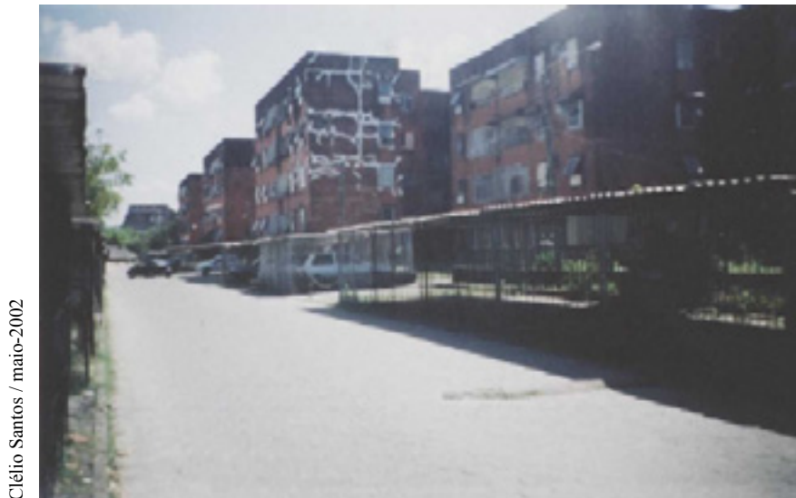
FOTO 15: Rachaduras nos Blocos de Apartamentos
