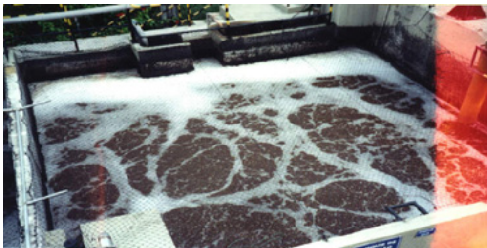
Figura 4.7 - Tanque de aeração
