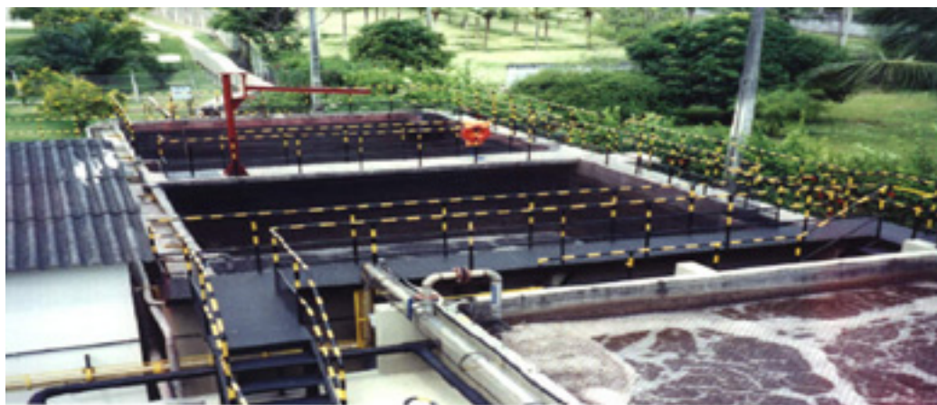
Figura 4.6 – Tanques de equalização
