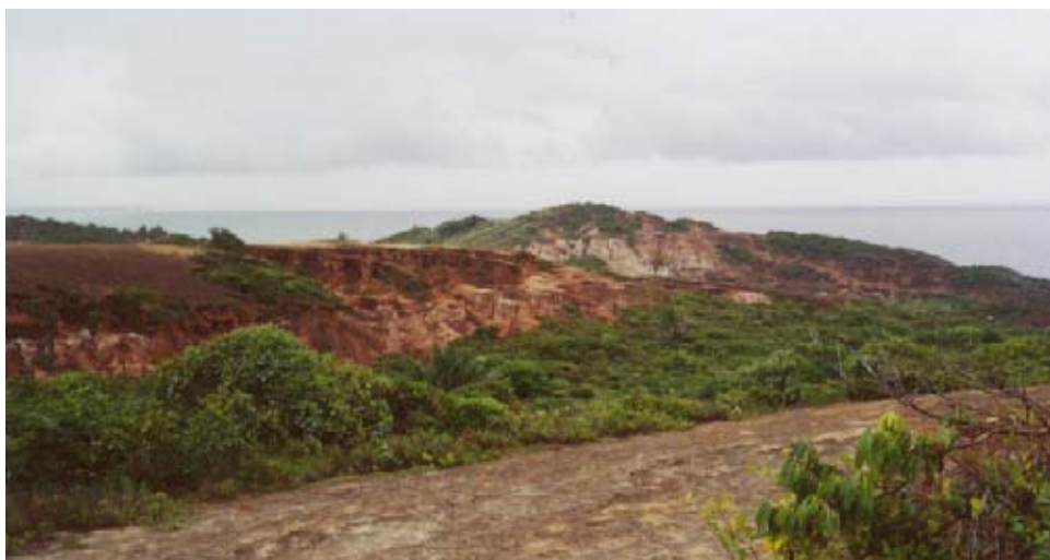
Foto III.7 - Vista Geral da Boçoroca em estudo.
