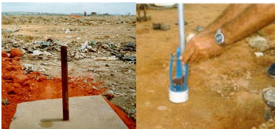
Foto 3.1. Placa de recalque superficial e Medidor de recalque em profundidade (aranha) respectivamente
