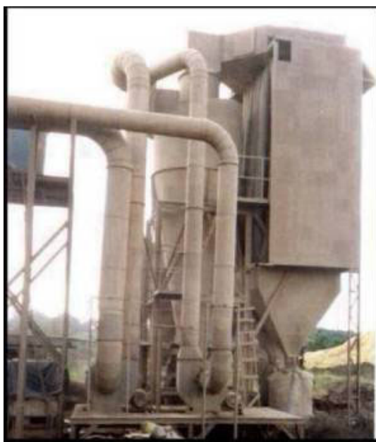
Foto 6.1 – Filtro Manga (retenção do pó da argila)
