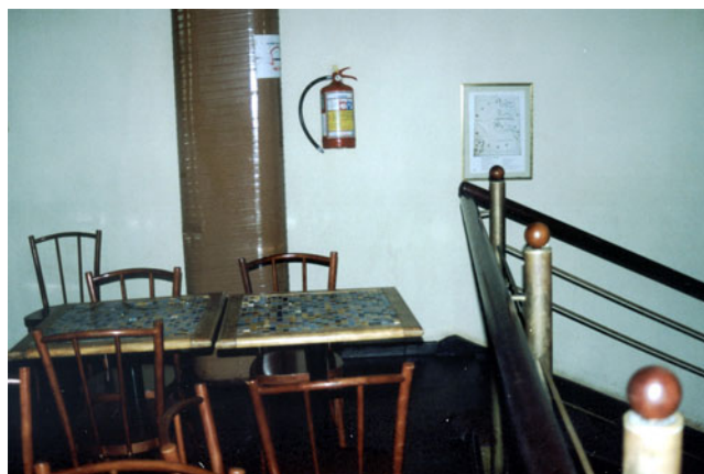
Figura 6.12 – Extintor de incêndio em local impróprio, no início da escada.
