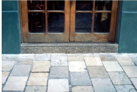
Figura 6.5 – Observa-se uma diferença de nível na porta principal, o que causa impossibilidade de acesso aos cadeirantes ou quaisquer pessoas com dificuldade de locomoção.
