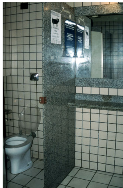
Figura 6.14 –No pavimento térreo não existe banheiro, este está localizado apenas no mezanino.
