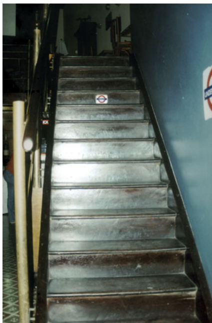
Figura 6.13 – Escada de acesso no térreo ao mezanino mal dimensionada, com espelho variando em torno de 19 cm e 12 cm.
