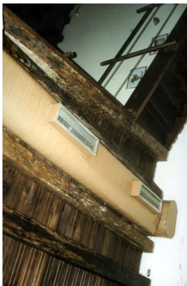
Figura 6.6 – Material combustível no mezanino (madeira), além de toda estrutura da escada, agregado também um material combustível da tubulação de ar condicionado
