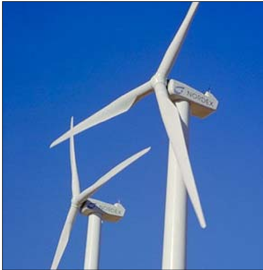
Figura 3.11 – Turbina eólica Nordex N60 1.300 kW.
