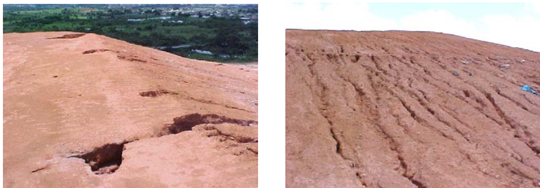
Figura IV.4. Erosão intensa verificada nos taludes da Célula nº 8.
