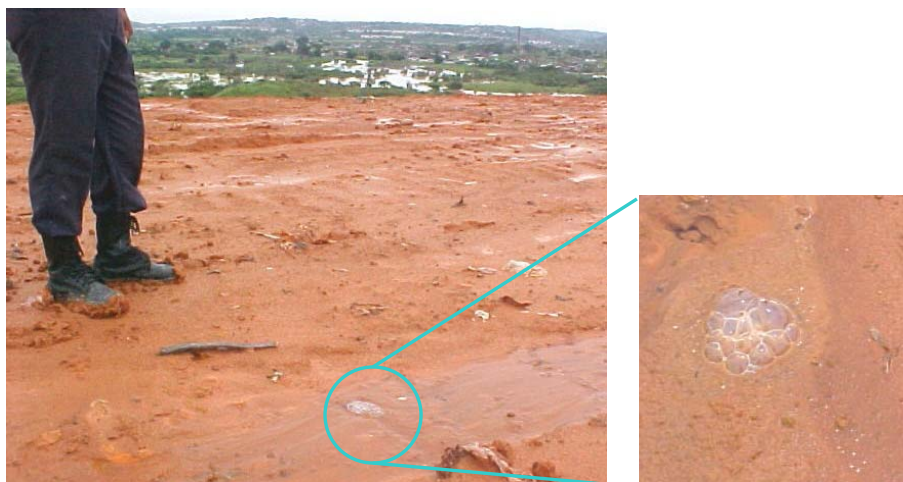
Figura V.18. Surgimento de bolhas de gás na cobertura da Célula nº 8.
