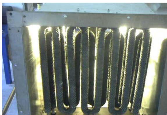
Figura 5.19 – Detalhe do conjunto de resistências.
