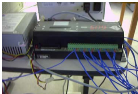
Figura 5.35 – Detalhe da ligação dos termopares ao Logger.
