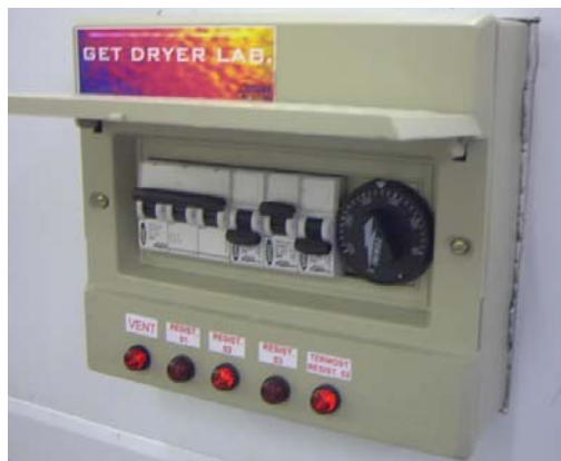
Figura 5.25-Painel elétrico para acionamento
