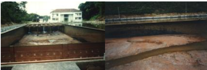
Figura 5.3: Decantador da ETA Gurjaú.
