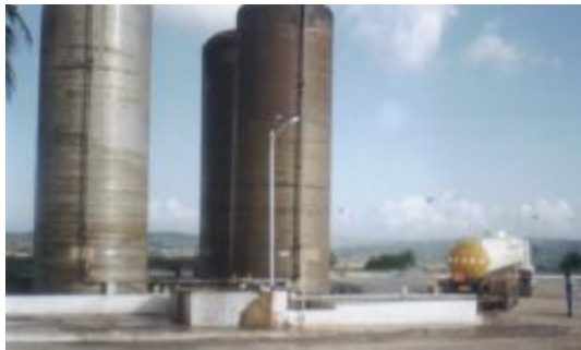
Figura 5.1: Recebimento do sulfato de alumínio líquido, na ETA Tapacurá.
