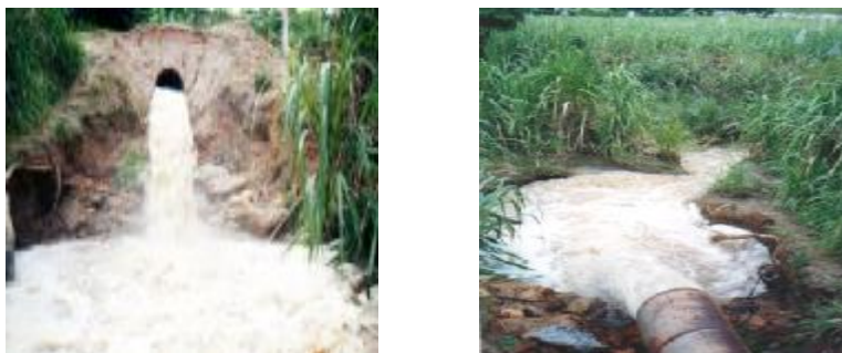
Figura 4.2: Lançamento dos resíduos gerados na ETA Gurjaú.
