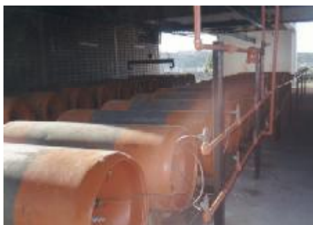
Figura 5.2: Armazenamento dos cilindros de cloro na, ETA Tapacurá.
