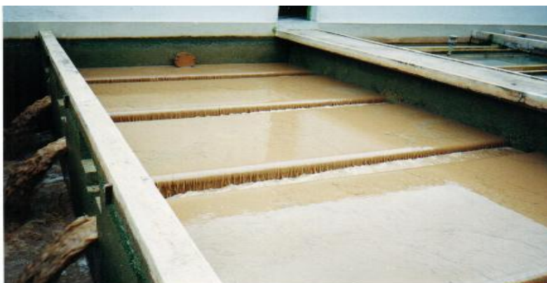
Figura 6.1: Lavagem do filtro na ETA Gurjaú.
