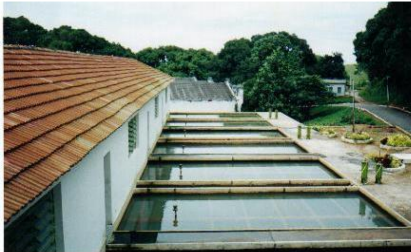
Figura 2.4: Filtro rápido da ETA Gurjaú.
