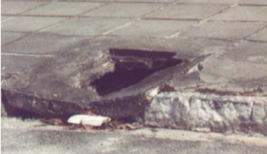
Figura 33- Boca coletora esmagada e furto da tampa de inspeção. (Olinda, jul/2002).
