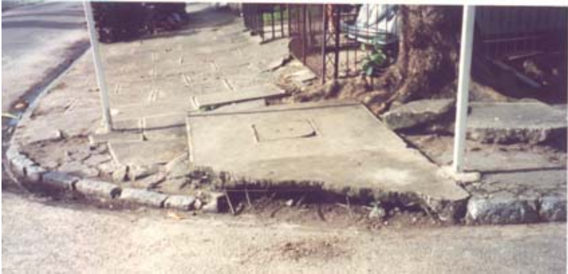
Figura 42- Ferros aparentes de boca coletora em grave risco para pedestres (Olinda, jul/2002).
