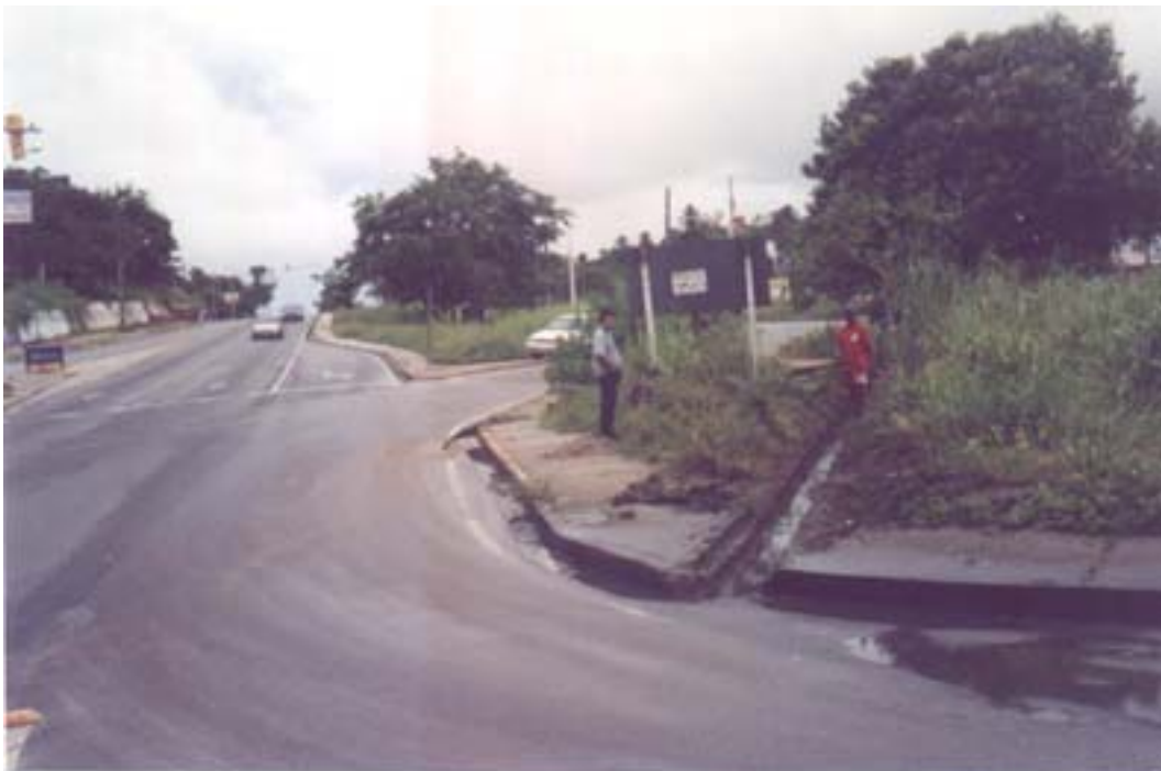
Figura 79– Canaleta partindo de boca coletora para o Riacho do Bultrins.
