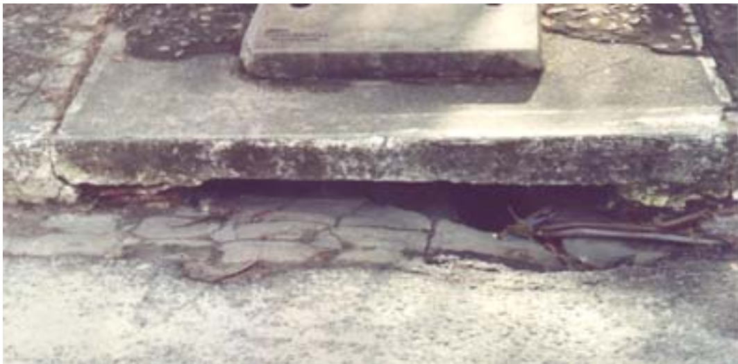
Figura 36- Tampa de inspeção criminosamente invertida (Olinda, jul/ 2002).
