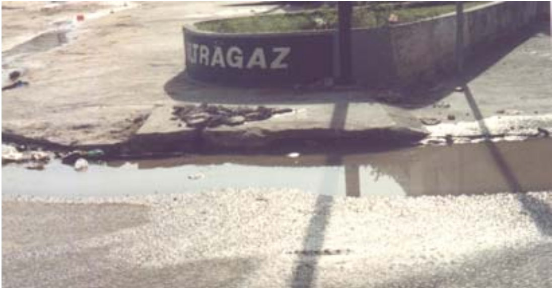
Figura 39- Laje superior de boca coletora destruída no tráfego de pedestre (Olinda, jul/2002).
