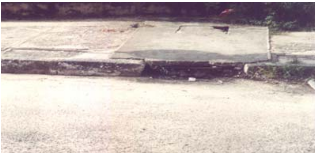
Figura 41- Ferros corroídos de boca coletora com risco para pedestres. (Olinda, jul/2002).
