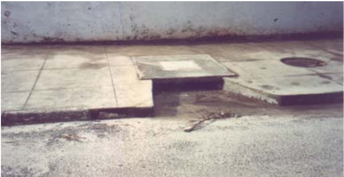
Figura 38- Modificação da abertura da boca coletora (Olinda, jul/2002).
