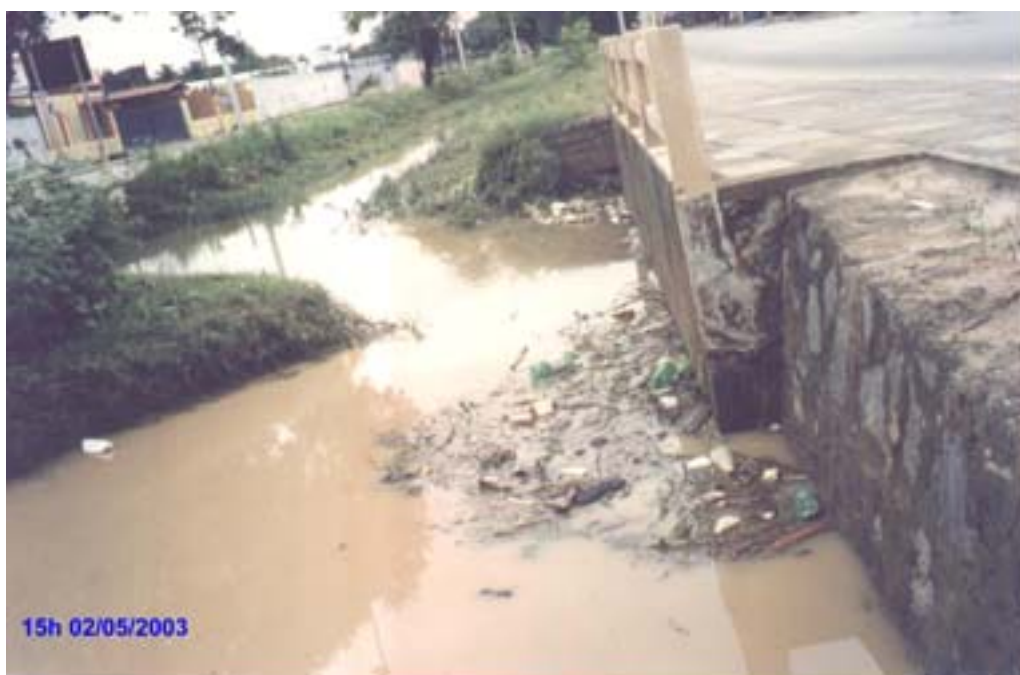
Figura 62 - Lixo acumulado na ponte da Av. Bultrins.
