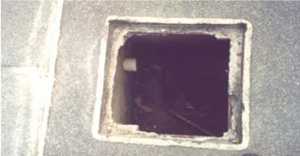
Figura 35 - Tampa de inspeção furtada (Olinda, jul/2002).
