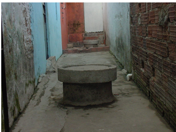
Figura 7.15: Caixa de passagem, na Mangueira, com o nível mais elevado, que o o piso da casa. Recife, 2003.
