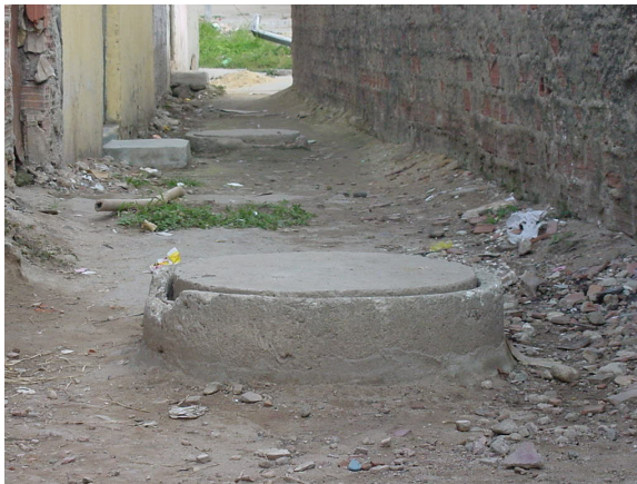
Figura 7.11 - Caixa de passagem danificada. na Mangueira. Recife, 2003.
