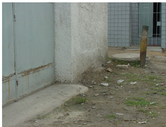
Figura 7.16- Caixa de passagem, na Mangueira, com o nível mais elevado, que o piso da casa. Recife, 2003.
