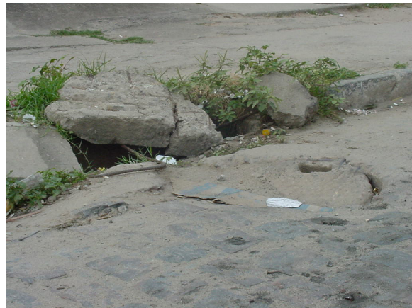
Figura 7.12 - Poço de visita danificado, na Mangueira. Recife, 2003.
