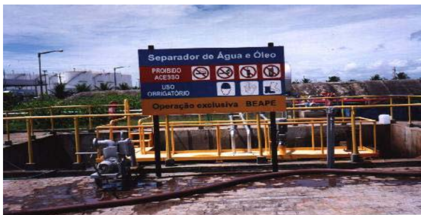
Figura 3.3: Vista frontal do SAO, localizado na BR-Distribuidora.
