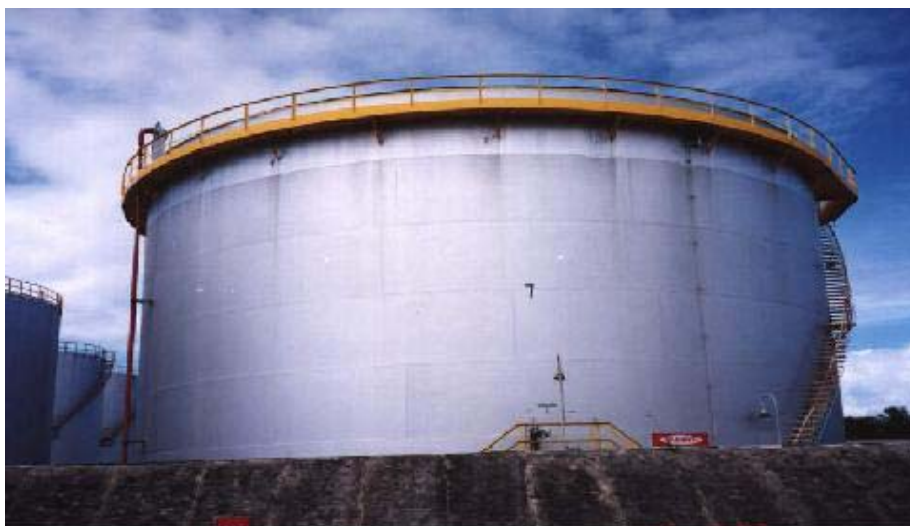
Figura 3.2: Tanque de armazenamento de gasolina, localizado na BR-Distribuidora.
