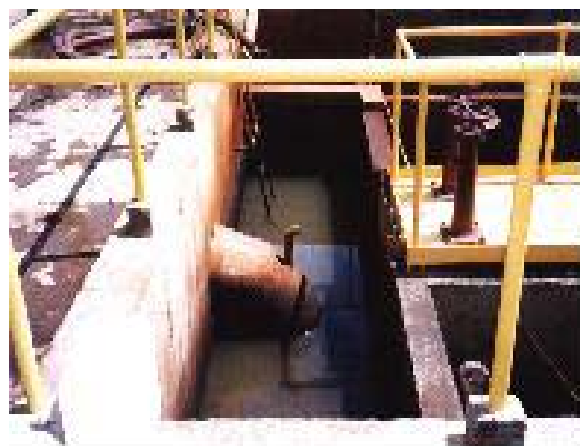
Figura 3.6: Vista da entrada do afluente no SAO.
