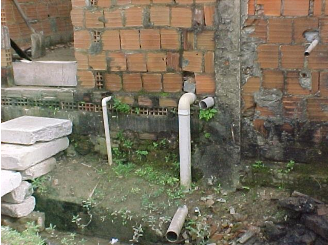
Foto 3 – Falta de saneamento.
