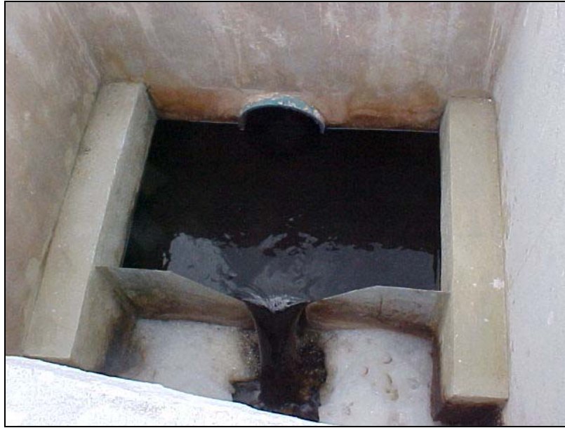
Figura 3.9 – A caixa medidora de Vazão
