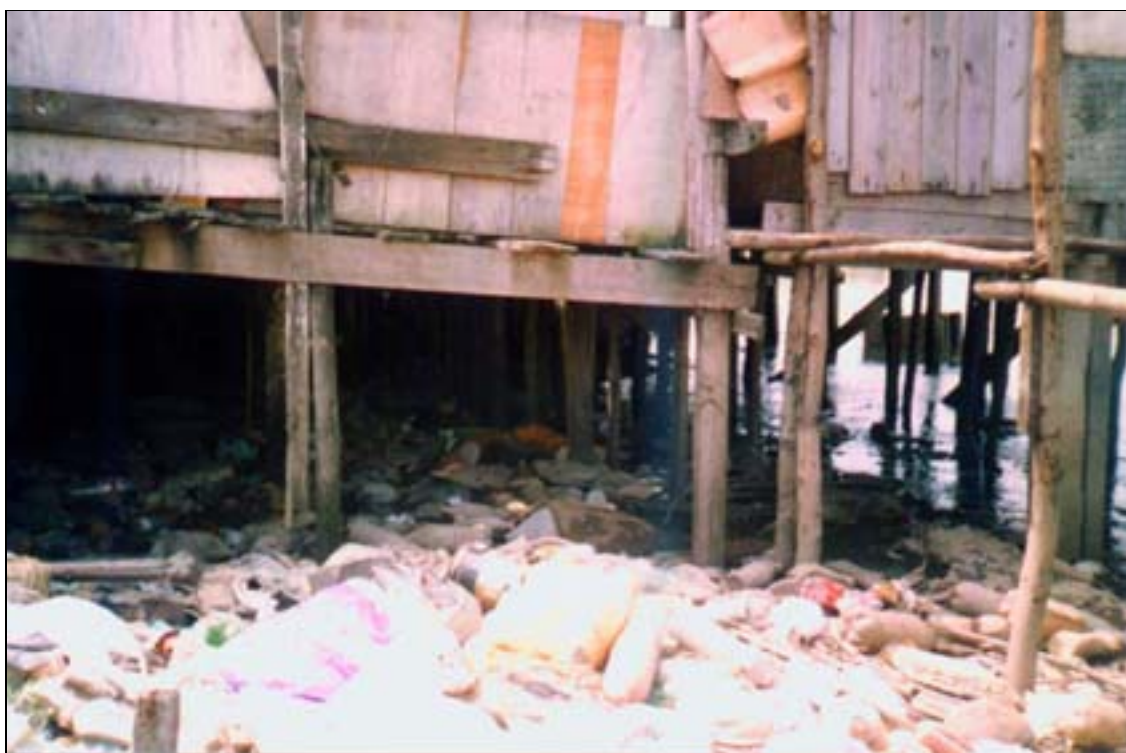
Foto 03: Estrutura das palafitas e problemas adjacentes
